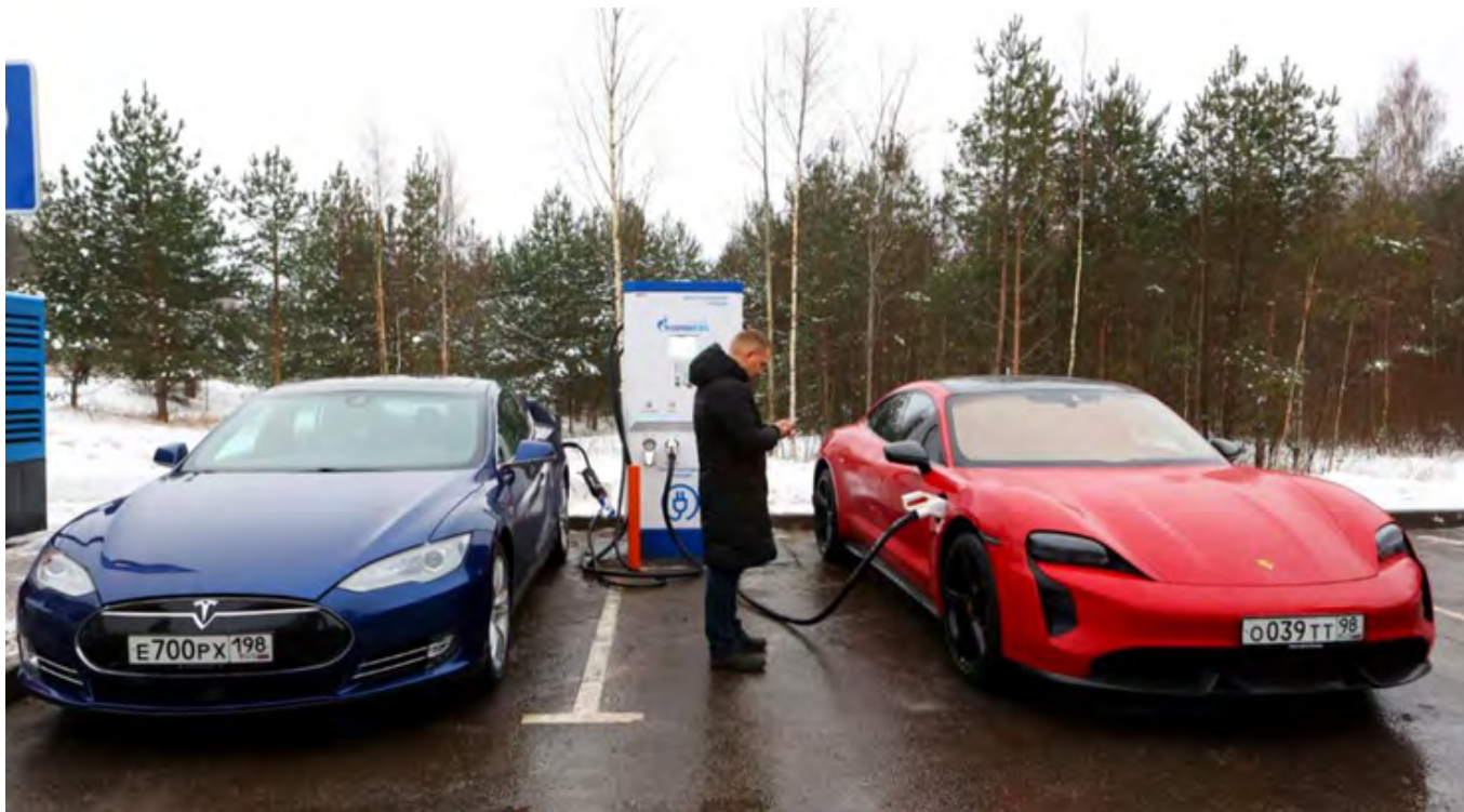
Электрозарядная станция на Мурманском шоссе на территории АЗС Газпромнефть
