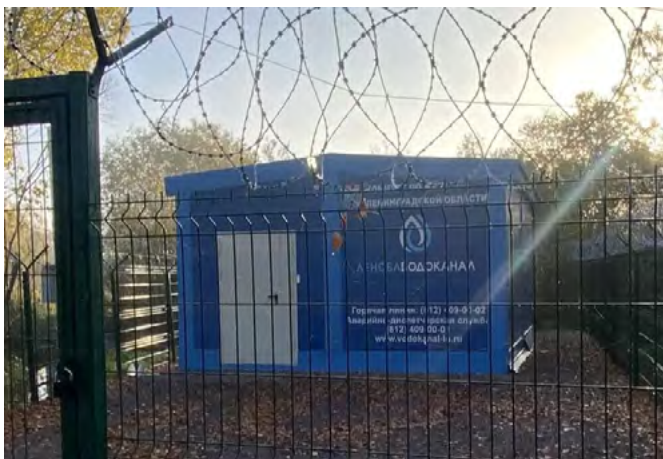
Станция водоподготовки в мкрн Пороги Волхова
