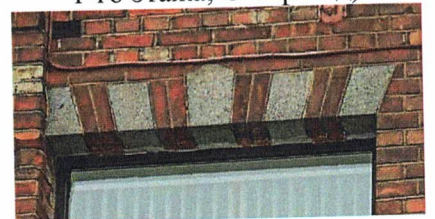
Гранитные вставки перемычки проемов 2-го этажа (С-3 фасад)
