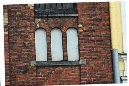
Ложные проемы, Ю-З фасад
