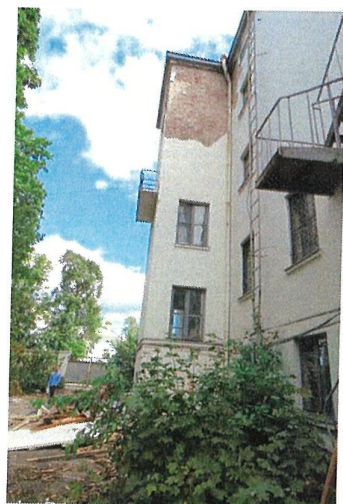
Ю-З фасад дворового ризалита
