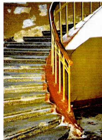
Центральная ЛК. Фото 2003 г.
