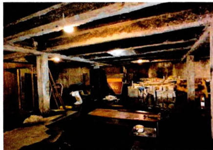
Уличный корпус. Подвал. Пом. 0.51. Монолитное ж/б ребристое пустотное перекрытие (нижняя часть перекрытия утрачена)
