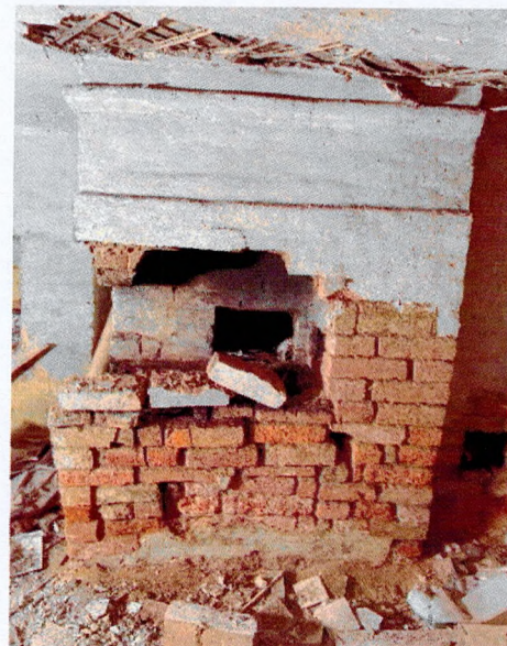
Печь в цокольном этаже
